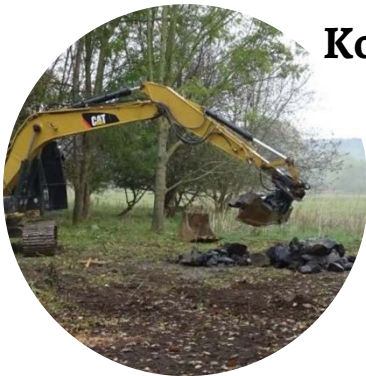
Fotos: Entnahme des Uferverbauabschnitt 2 (links) und entstieintes Leineufer Abschnitt 3 (rechts); [Ingenieurgesellschaft agwa GmbH, 2022]
